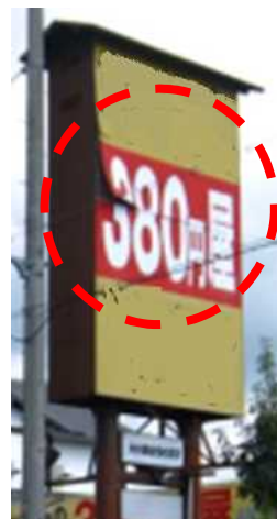
板面（表示面）の剥離が見られる 建植え広告物。
