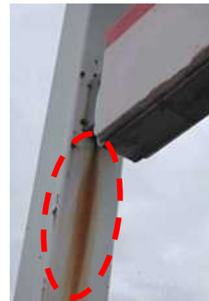
看板本体からポールや壁面への汚ダレは取付部分（ブラケット）の腐食サイン
