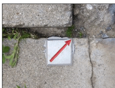
⑬ 境界標識：金属プレート
