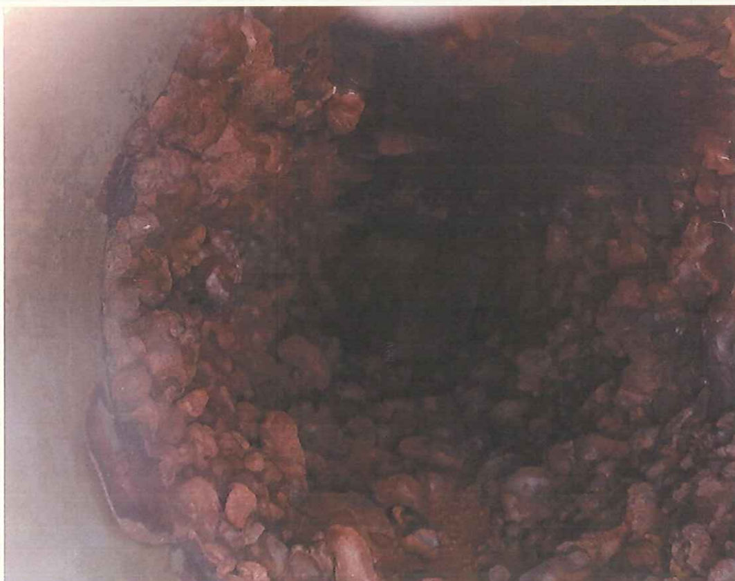
② 1976年製 基幹管路 1工区 既設送水管 φ300内部 錆こぶ状況
