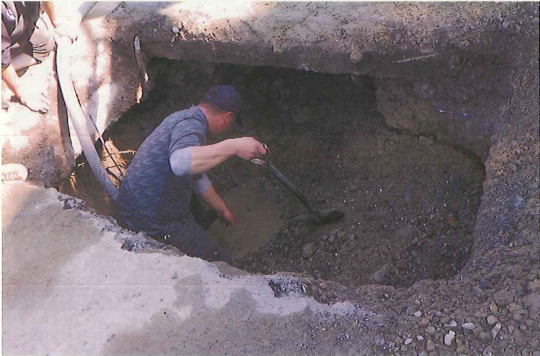
③ 1996年製 2020.2漏水 舗装下空洞 奥行1 m
