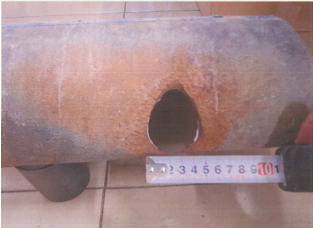
④ 1996年製 2020.2漏水 直管部側面 \phi 200 鑄鉄 穴 \phi 40 \sim 50
