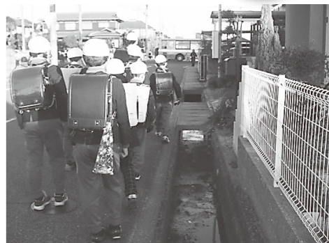
▲危険な側溝の放置はできない!
