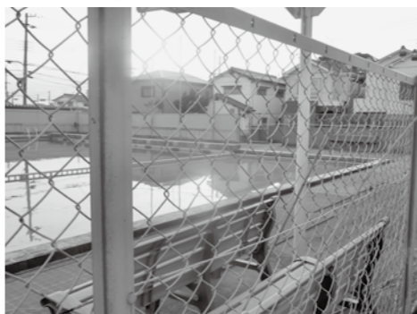
▲全面改修を待つ播小プール
